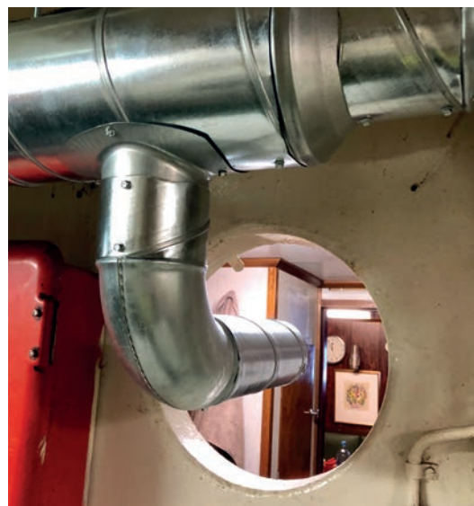
Uheldig skottgjennomføring (vann-og brann barrierer er brutt)
