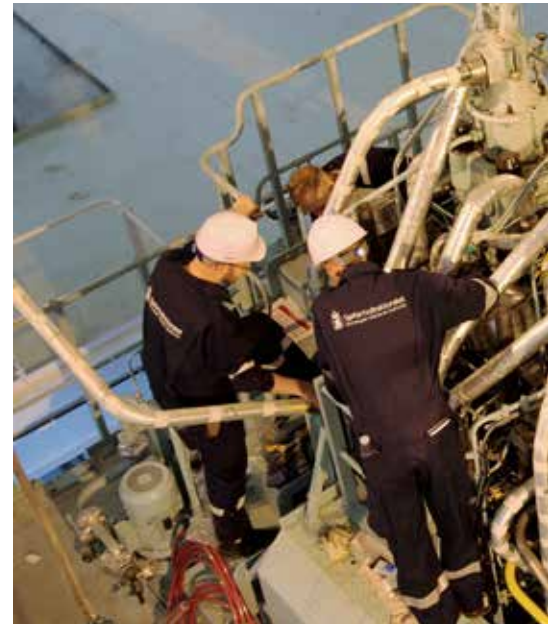
NYTT: Rørsystemet som fører metanol til motoren var av stor interesse for Sjøfartsdirektoratets ingeniører.
