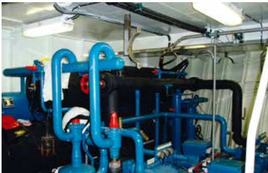
RSW-KJØLEANLEGG: Kjøleanlegg med ammoniakk er effektive og miljøvennlige, men det er viktig å være klar over hvilke forholdsregler man må ta.
