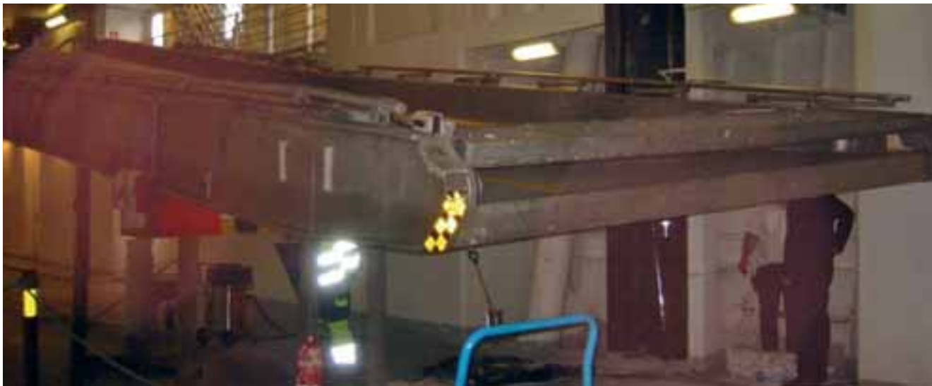
HENGEDEKKET slik det ble stående etter sylinderehavariet. Hengedekket hviler på løftesynderens som kan ses nede til høyre i bildet.
