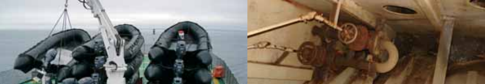
FRA TOPP TIL BUNN. Ved en såkalt "more detailed" PSC sjekkes båten fra øverst til nederst.
