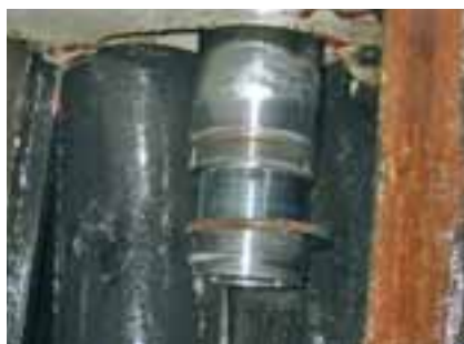
HAVARERT LØFTESYLINDER. Hengedekkk hviler på sylinderhuset til venstre i bildet.
